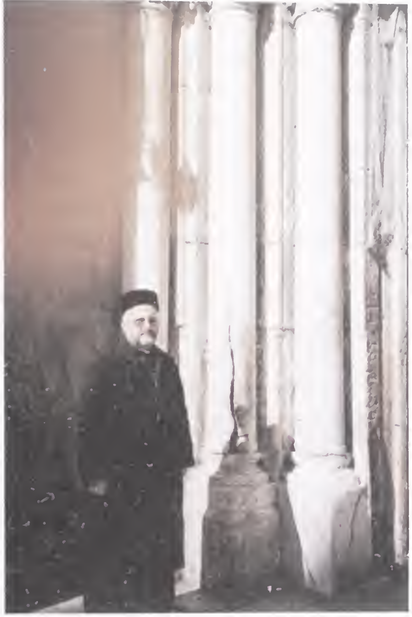
Kıyamet Kilisesi'nin giriş kapısındaki sütunları, orta sütunun çatlak olduğu görülmektedir. Çatlama sebebini yandaki paragrafta okuyabilirsiniz.
